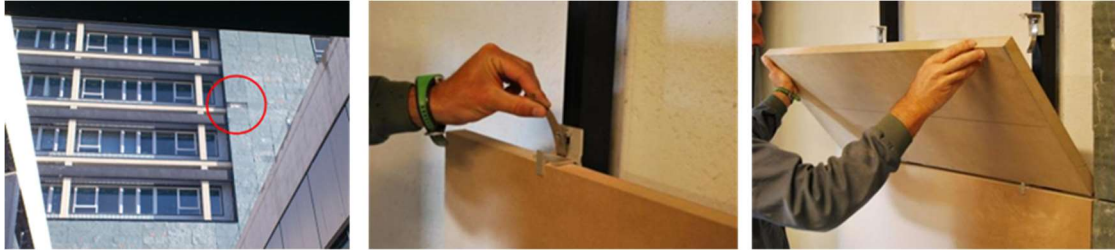
Figura 6. Investigación sobre desprendimientos de piezas de aplacado en la fachada del HUBU (Burgos)
